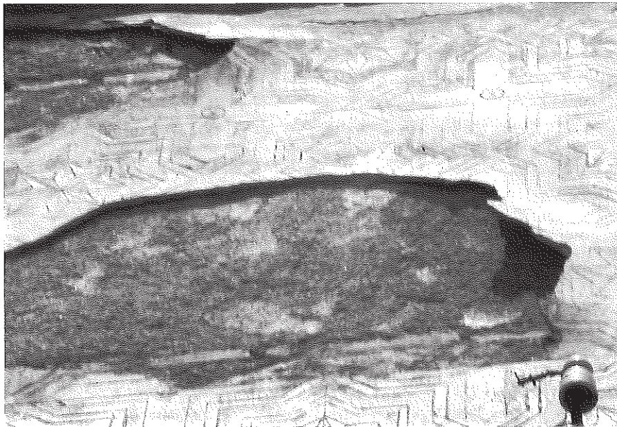
8. Daños en la planta primera de la fachada de la Casa del Obispo: la capa de enlucido se ha separado del enfoscado provocando abolsamientos, fisuras y lagunas. El motivo geométrico pertenece al tipo de dibujo cerrado, coloración policroma —amarillo ocre, rojo de almagra, negro de humo y el blanco del enlucido— y aplicación cubriente
