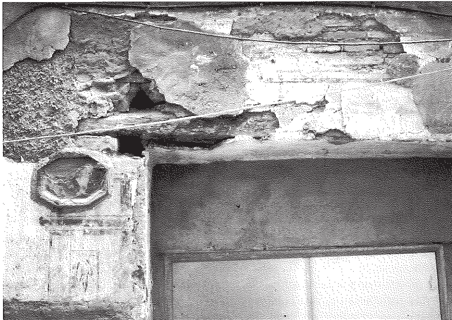
6. detalle de la fachada del edificio de Calle Nuño Gómez, 8. Pérdidas de revestimiento que dejan a la vista la fábrica de ladrillo, el cargadero de madera, las reparaciones con cemento y el cierre de vanos.
