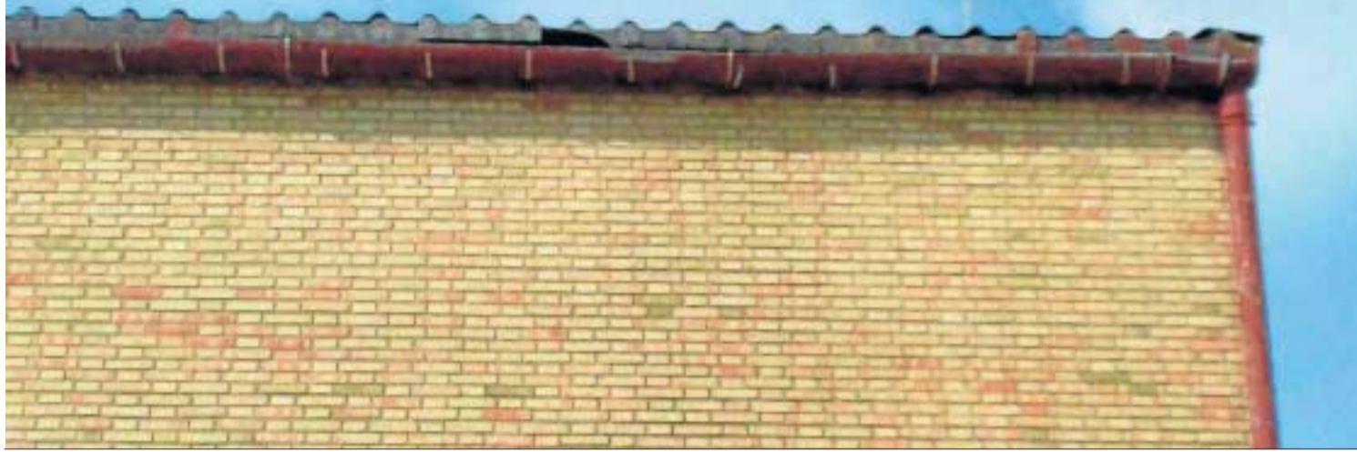
Cubierta del gimnasio en la que se observa un trozo de amianto desprendido.
